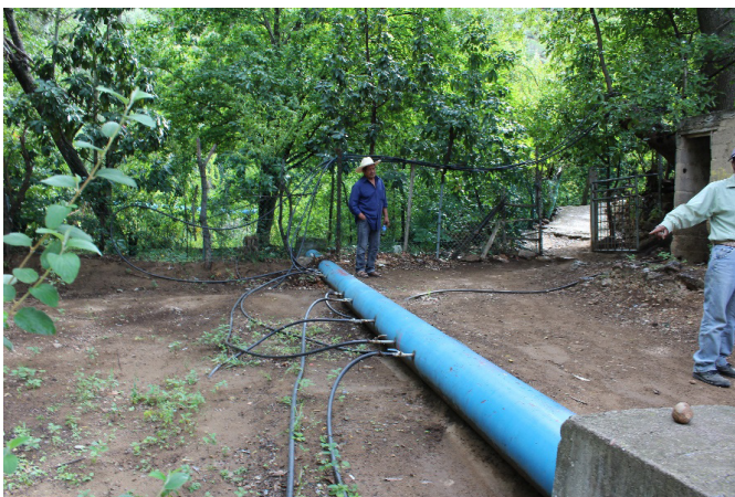
Figura 4. Tomas de agua en San Bartolo, San Luis Potosí
