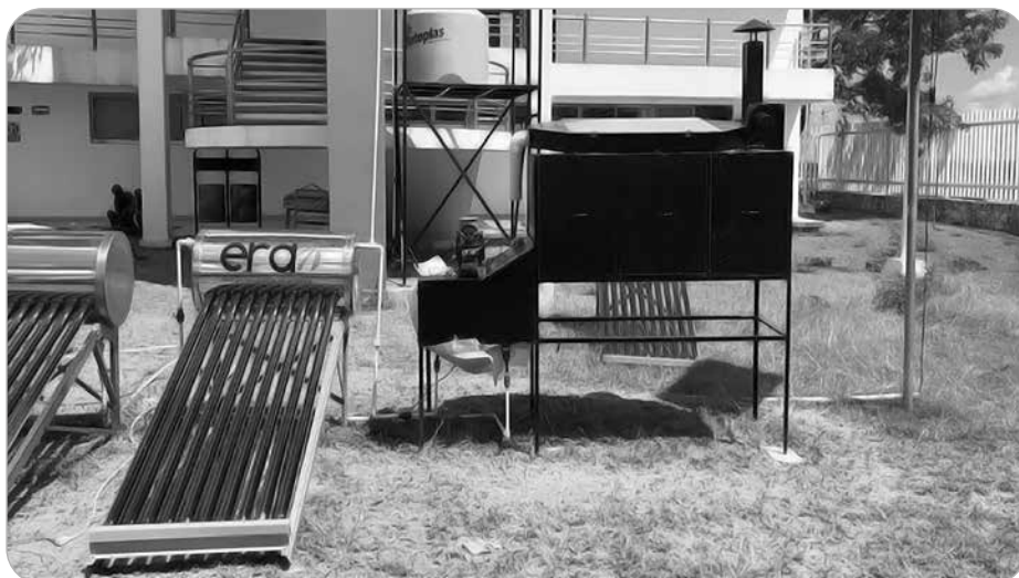
Figura 2. Secador solar indirecto con combinación de tecnologías solares en el Laboratorio de Secado Solar de la Facultad de Ingeniería de la Universidad Autónoma de Campeche.
